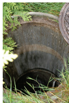
Schachterhöhung mit Brunnenring
